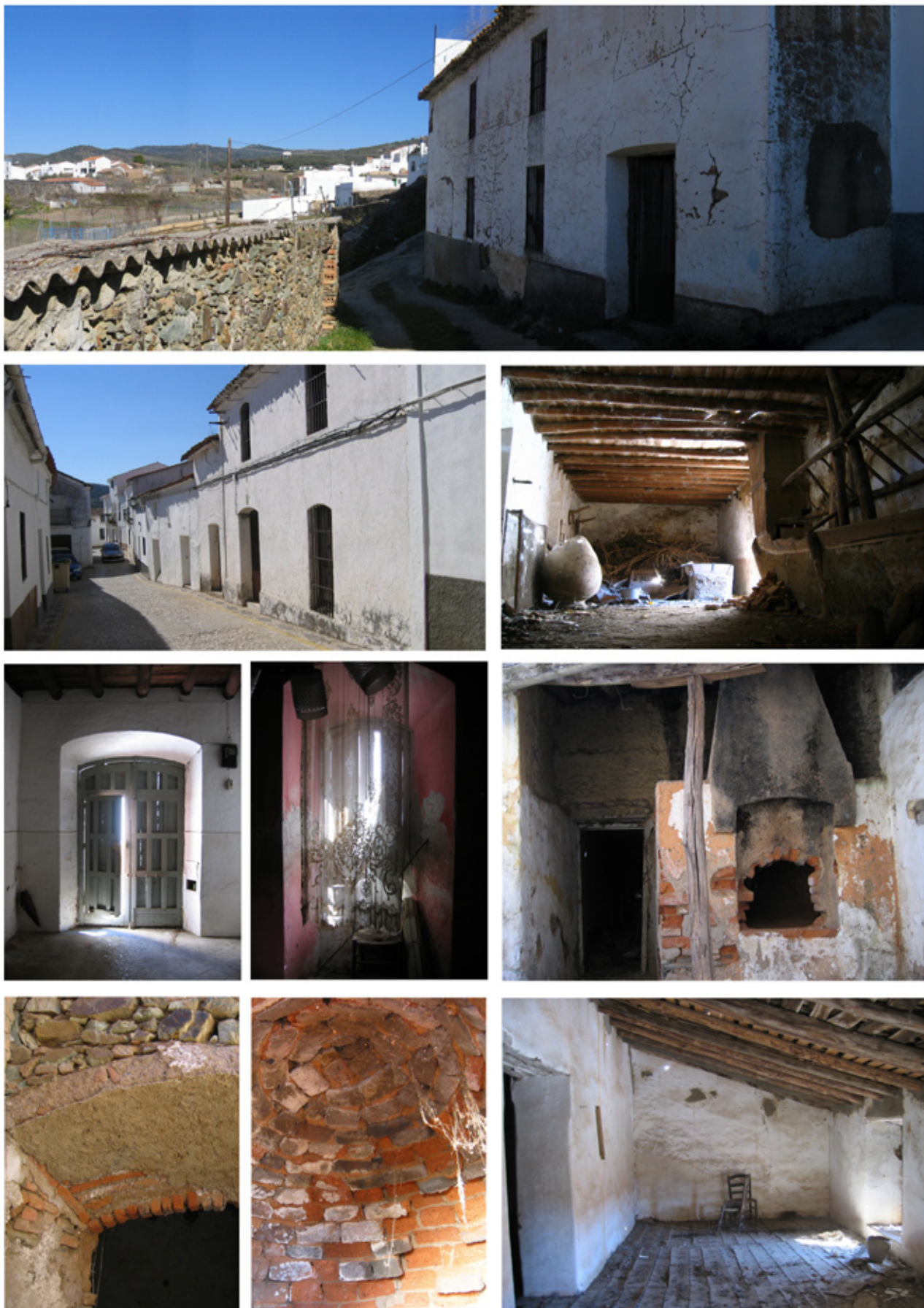
Diversas imágenes de la vivienda: fachadas trasera y delantera, nave de la cuadra, puerta del zaguán, ventana a la calle, horno, arco de ladrillo, bóveda del horno, cámara alta.
