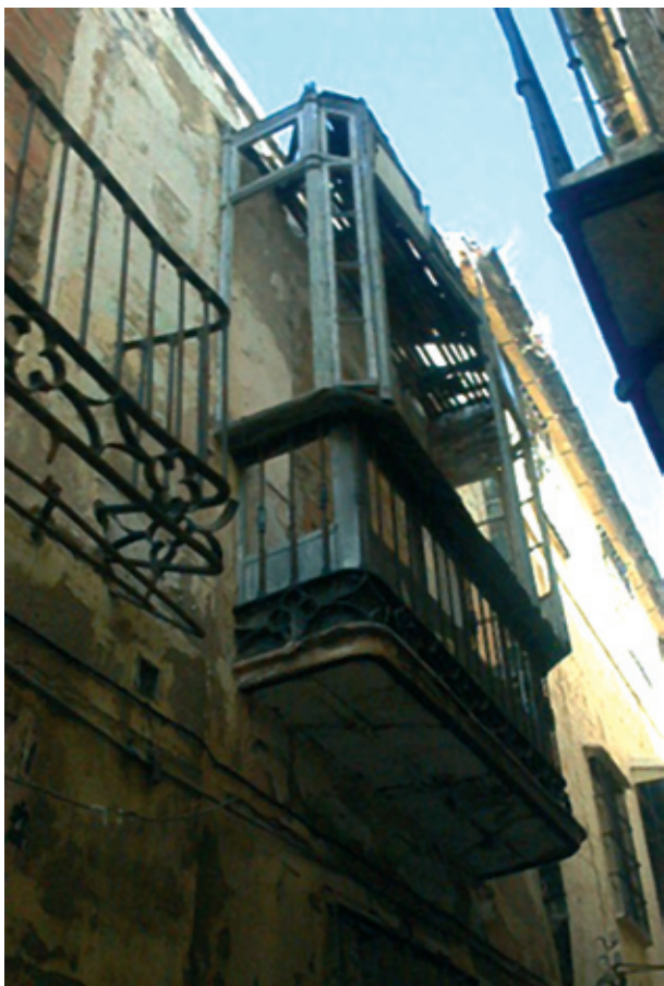
Deterioro avanzado de un edificio en estado de ruina y detalle de un balcón característico de la arquitectura malagueña del siglo XVIII (Calle Tomás de Cózar, entorno de la antigua judería, Málaga, 2002). Foto de la autora.
