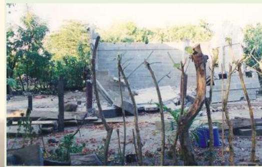
Foto II.1.1. Vivienda colapsada durante el terremoto del 13 de Enero de 2001 en el valle del Río Lempa. El Salvador.
