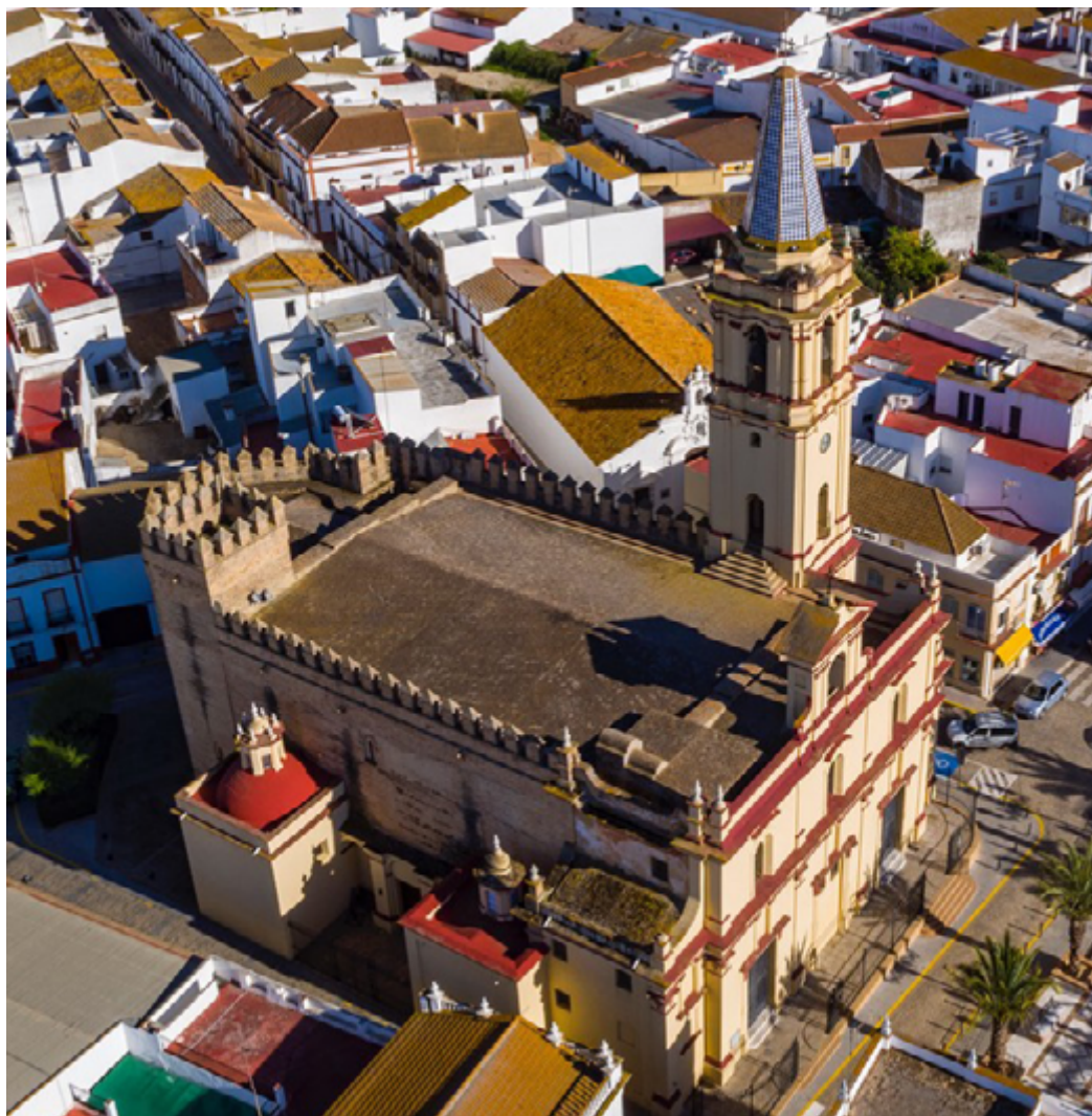
Figura 5. Parroquia de San Antón. Extradós de la bóveda de la iglesia. Trigueros, Huelva. Cortesía Clikaudiovisual SL y Ayuntamiento de Trigueros.
