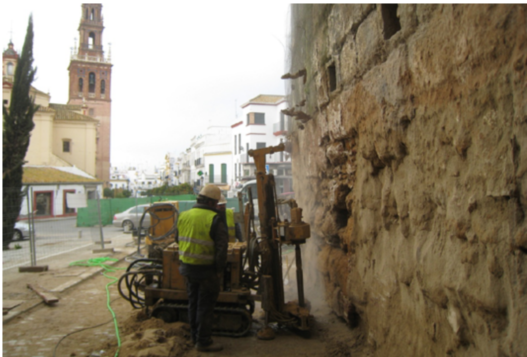
Figura 2. Tratamiento de recalce de cimentación de la esquina del Bastión de la Puerta de Sevilla de Carmona (fot. Eduardo Martínez Moya, 2010).
