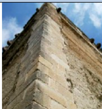
Zona superior esquina SE
