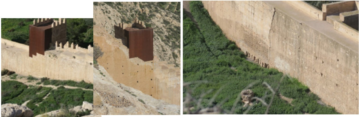
Torres 8 y 10; y desagües existentes en la cota más baja, entre torres 6 y 7 2019, M.V. Gómez de Terreros G.
