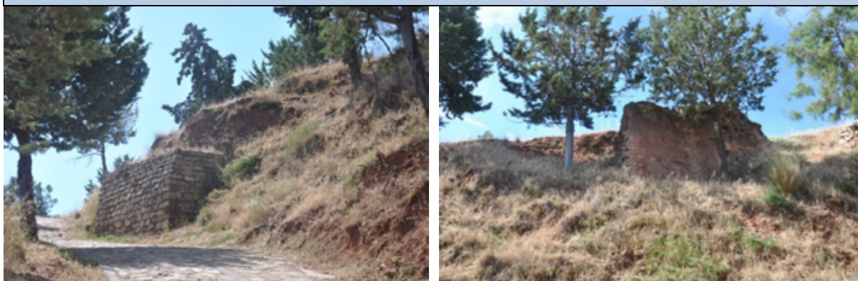
Camino de acceso y restos de estructuras de muros restaurados 2021, María Gracia Gómez de Terreros Guardiola
