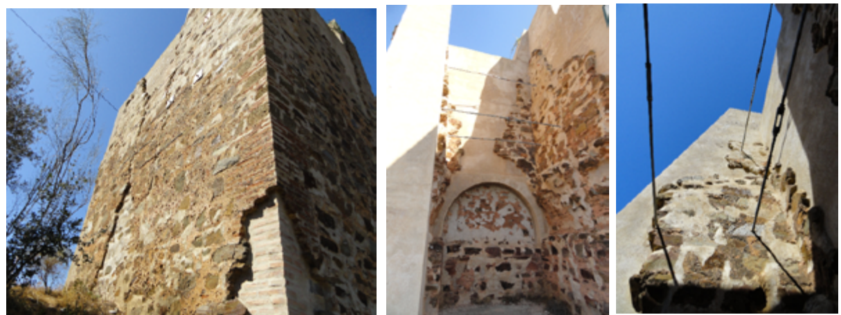
Restauración en esquina este, interior de la torre y tirantes internos 2020, Pedro Gómez de Terreros Guardiola
