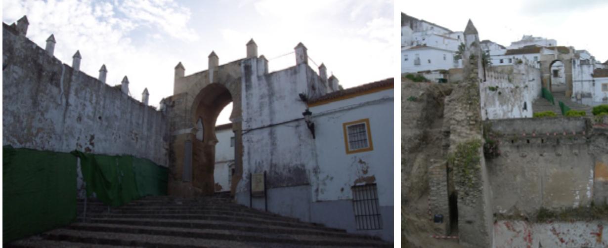
Arco de la Pastora e inicio de la muralla. Estado de la construcción tras el derrumbe producido en el año 2000 (durante excavaciones arqueológicas) 2005-2006, Salvador y Manuel Montañés Caballero
