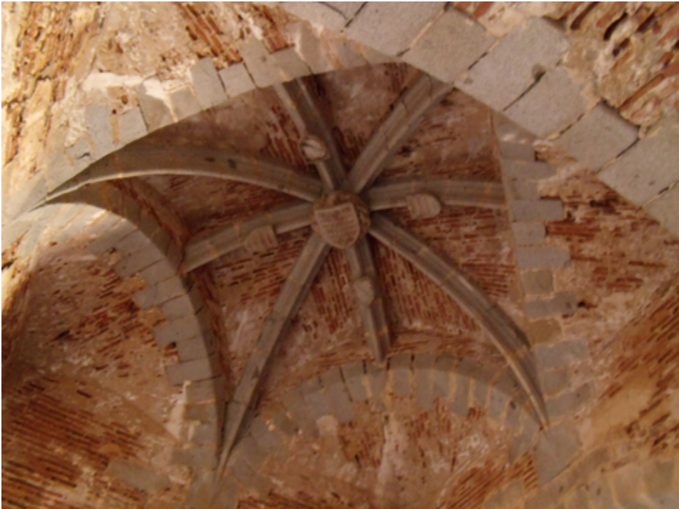
Figura 8. Bóveda del piso cuatro de la torre del homenaje del castillo de Belalcázar, Córdoba (fot. Asociación Andolises, Belalcázar, Córdoba, 2014-2015).
